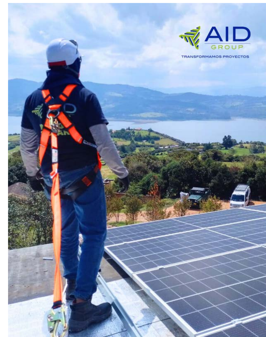
PROYECTOS DE ENERGÍA SOLAR
