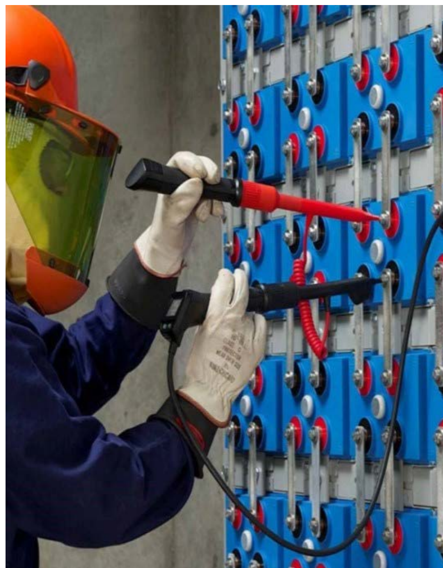
EQUIPOS DE ENERGÍA Y RESPALDO
